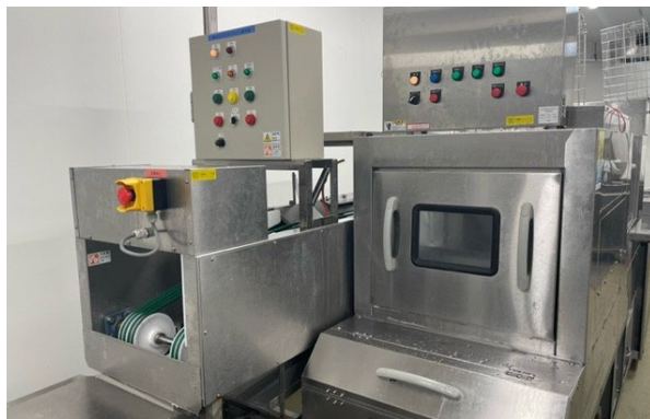
食堂設置/節水食器洗浄機の導入
